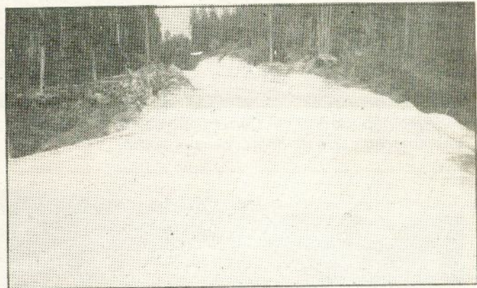
Nova estrada entre Paradelá e Cedrim - Trabalhos de abertura e terraplanagem avançam em bom ritmo.
