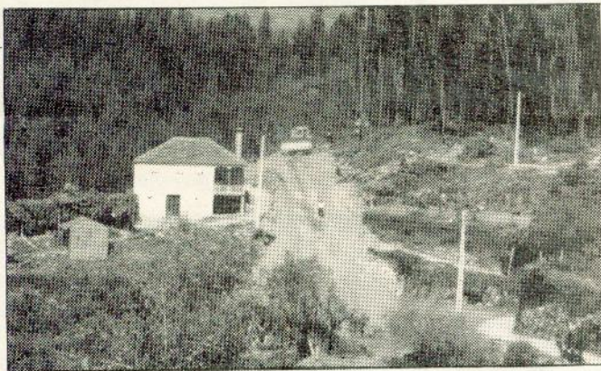
Trabalhos de abertura da estrada que ligará Cedrim a Paradelá. Início da obra (comparticipada em 75% pelo Feder).
