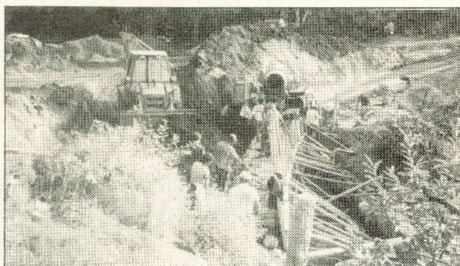
Zevedinho (Cedrim) — Construção de obras de arte para implantação correcta do novo arruamento.
