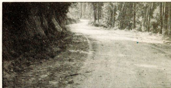
Trabalhos de abertura da ligação de Novelide a Covelo — (Comparticipados pelo Feder).
