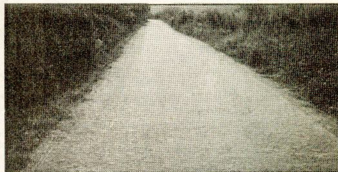
Ligação da Macida (Talhadas) ao extremo do Concelho (fronteira com Ageda). Uma obra do primeiro ano do mandato. →
