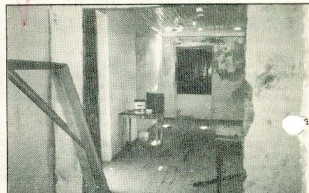
Obras de reconstrução e remodelação do antigo quartel da G.N.R. para instalação da nova Biblioteca Municipal
